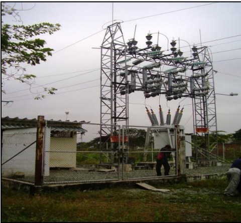
Foto. Subestación en la cabecera Parroquial
