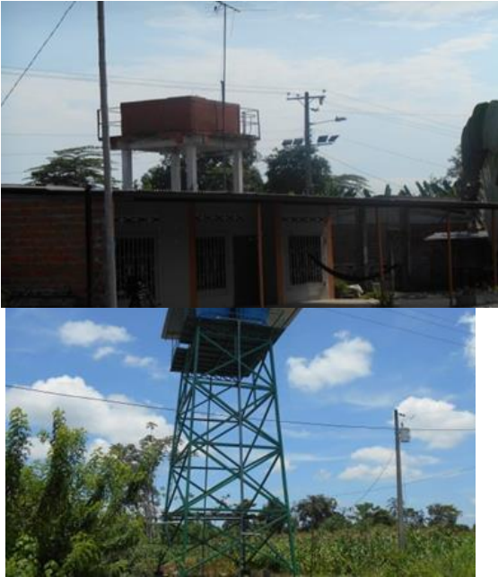
Foto. Sistema de agua del recinto rio Milagro
